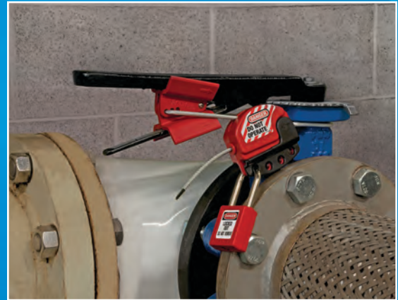
S3920 gesichert mit S806 Verriegelungskabel
